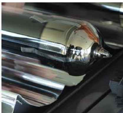
газопоглотитель в порядке, трубка исправная
